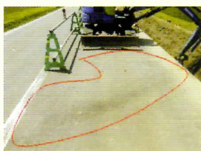
バックホーの作動油のホースが破裂して、舗装の上に漏れている。
